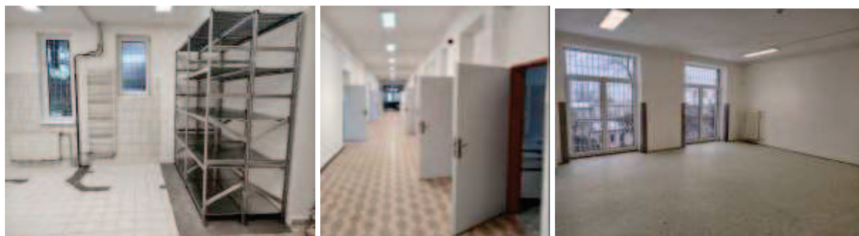
Klatovy, rekonstrukce budovy čp. 209/II., po kolaudaci zde budou připraveny nové depozitární prostory.
